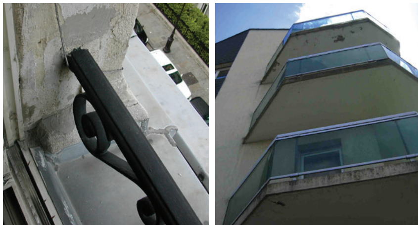
Figure 1 : Le diagnostic avant travaux doit prendre en compte la diversité des matériaux constitutifs de la façade
