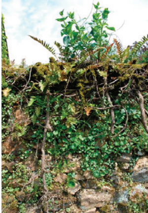
Figure 1 : Mur colonisé naturellement
